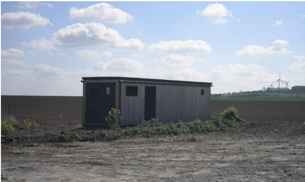
Figure 13 : Exemple du poste de livraison de la vallée de l'Aa (source : VALECO, 2017)
